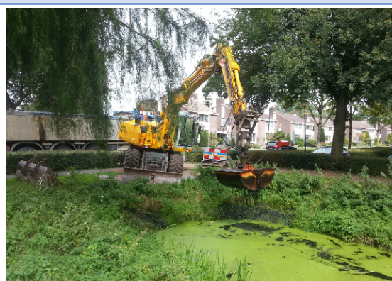
Figuur 29: slechte doorspoeling en slibaanwas leiden tot kroosvorming en dure beheersmaatregelen
